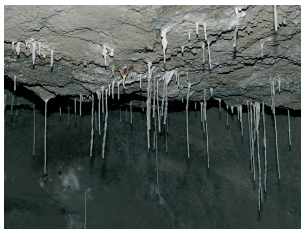
Obr. 1. Krápníkové útvary narostlé na betonové konstrukci jedné z chodeb podzemních prostor PVE DS. Nejdelší stalaktity mají délku 25 cm.
