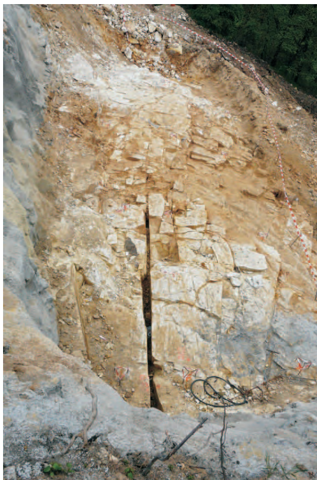
Obr. 6. Pohled od Z směrem dolů na stavební plošinu na s. straně údolí. V západní části plošiny široká trhlina, vzniklá rozevřením pukliny 2. řádu, vzadu patrná převaha puklin 1. řádu. Foto J. Valečka, 2008.
