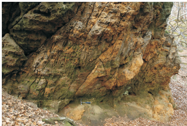
Obr. 2. Pásmo hustých ruptur ukloněné k severozápadu, dole ukončené na subhorizontálním zlomu se silicifikací a striacemi. Černý důl u Housky, 50,48609°N a 14,61950°E.
